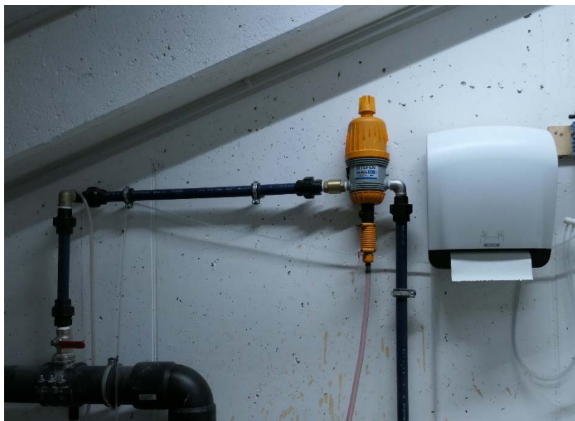
Abb. 1: Fertigationssystem innerhalb einer Sportplatzberegnung (J. Schüchen).
